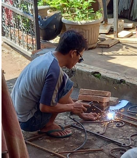
Gambar 2. Pekerja pengelasan tidak menggunakan APD.
